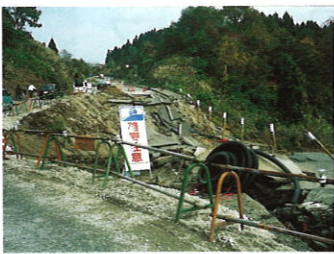
崩落した道路。傷痕も生々しく...
