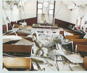
震災当時のままの結婚式場の教会 ここまで津波は来なかったが、地震の揺れだけで全てが崩れた
